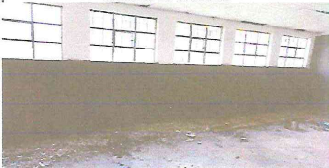
Foto 4: Repello de paredes en mal estado.
